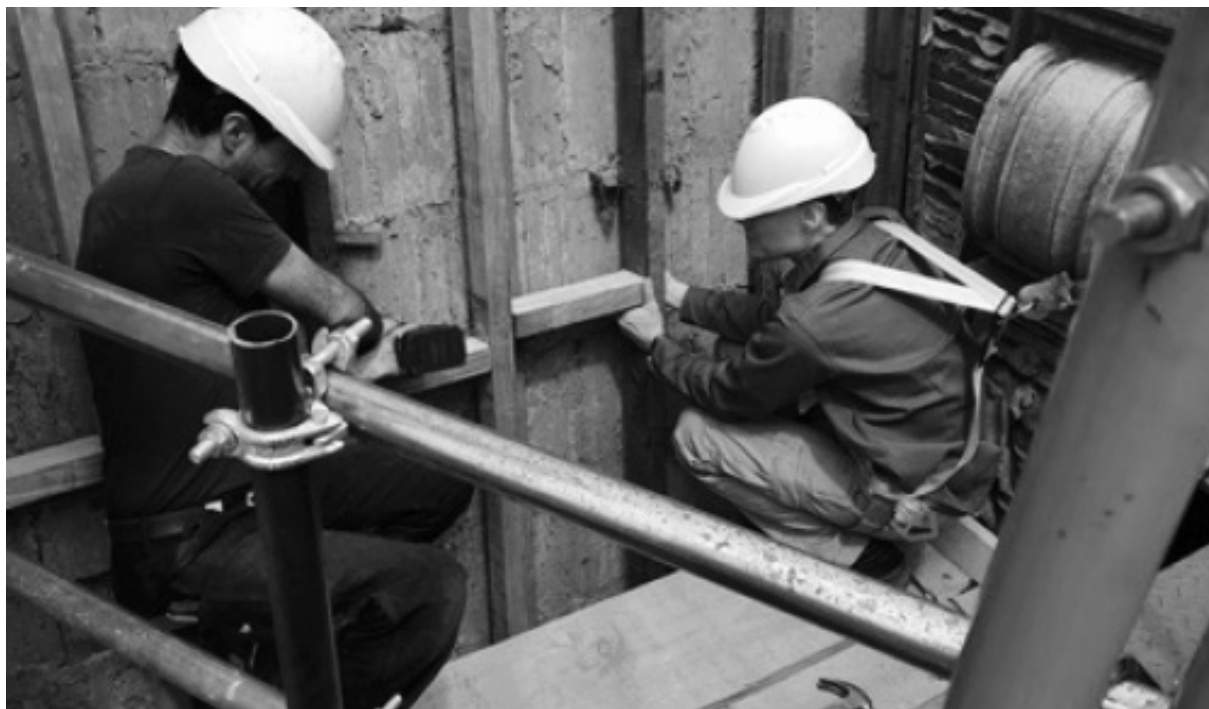
Imagen 1: Foto de la mansarda intervenida en la EIS. Reposición de elementos estructurales de madera. Noviembre 2022.
