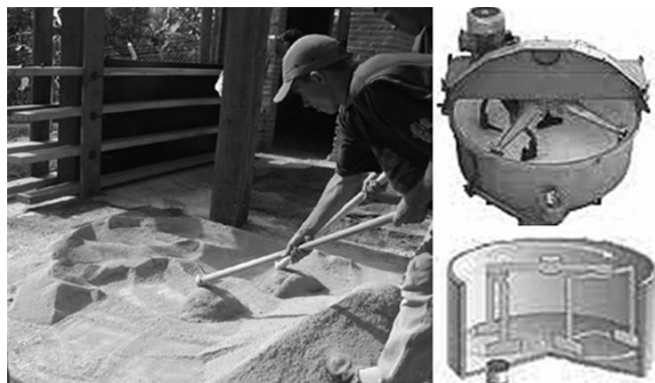
Figura 15 - Preparación de la tierra con la adición de cal y cemento y ejemplos de mezcladoras planetarias
