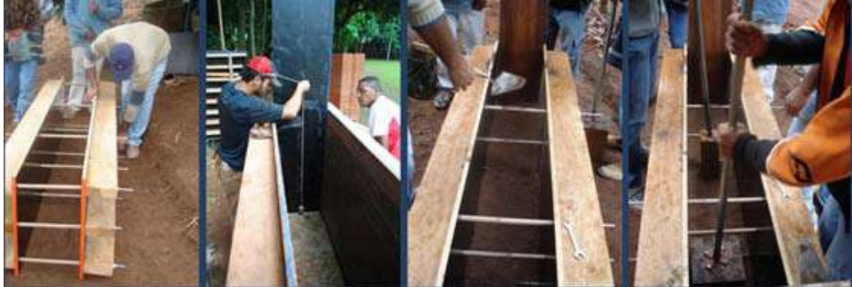
Figura 16 – Acciones para montar y aplomar el molde, desparramar y compactar la tierra
