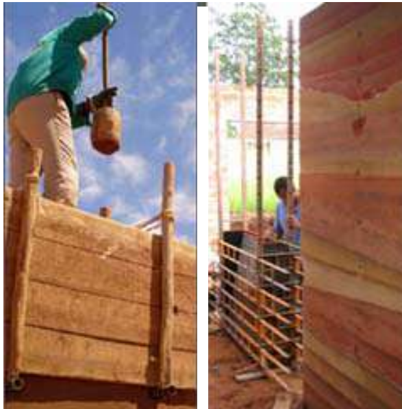
Figura 2 – Dos tipos de moldes para ejecución de la tapia: tapial tradicional (a la izquierda) y tapial metálico
