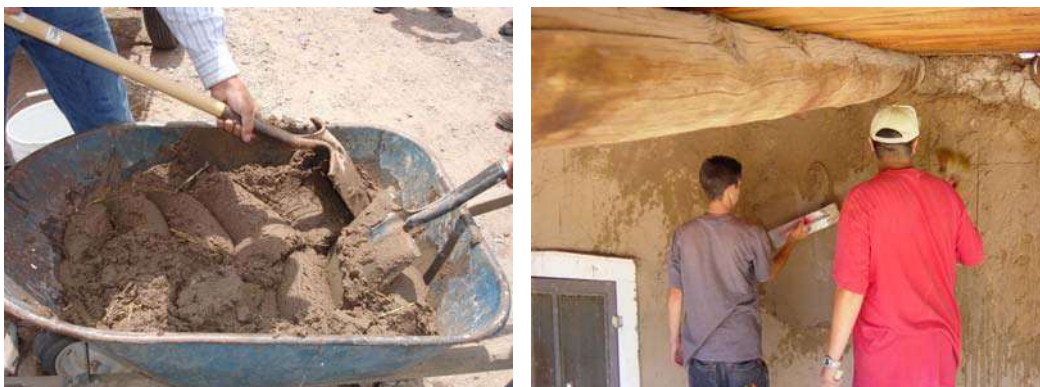
Figura 4 - Mezcla para revoque final de barro y su aplicación con la llana
