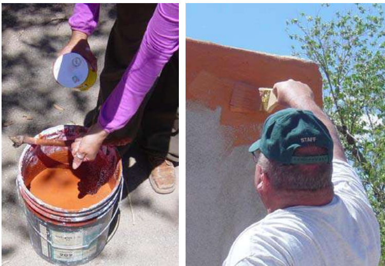
Figura 9 – Agregado de sal a la cal pigmentada y aplicación de la pintura en la pared preparada
