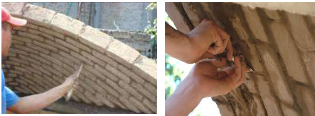
Figura 12 –Proceso de limpieza de las juntas de colocación, superficie y esquinas de la bóveda
